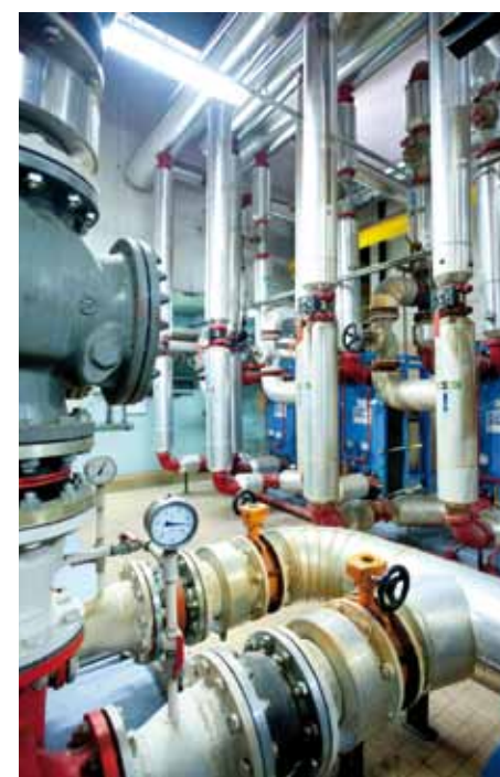
D'imposants tuyaux et machines sont nécessaires pour chauffer l'eau.
