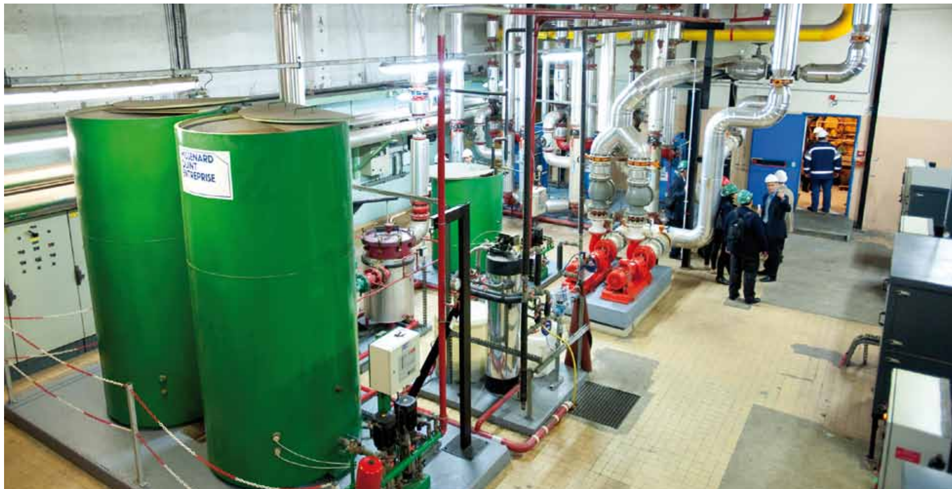
Place Alfred-de-Musset, à l'intérieur de la centrale de cogénération.
